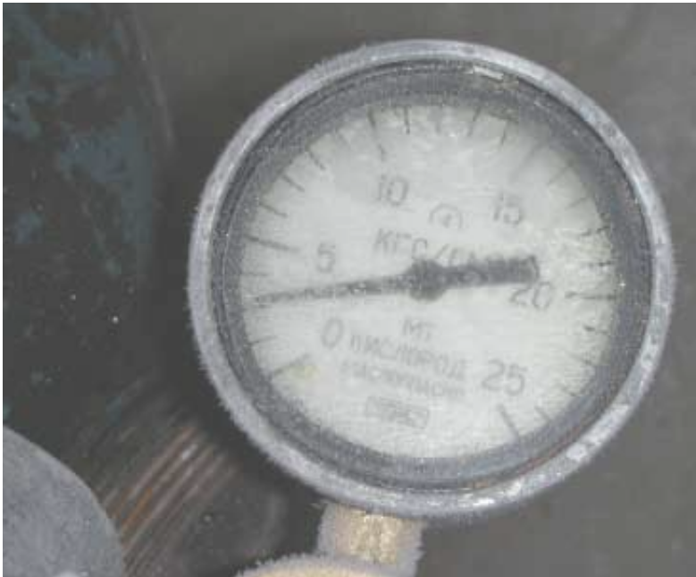
Manomètre de pression de sortie de l'azote dans la bulle
